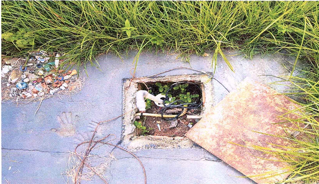
Figura 16 – poço sem uso
