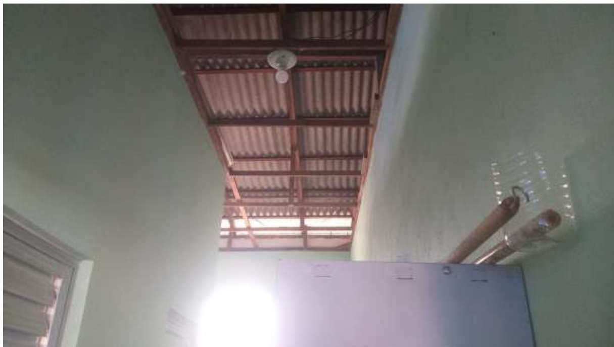
FOTO 02 – FORRO DE PVC NO BANHEIRO DAS CRIANÇAS
