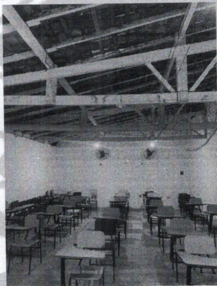
Figura 10 – Vista de madeiramento de telhado comprometido por infiltrações, deformação da estrutura e presença de cupins.
