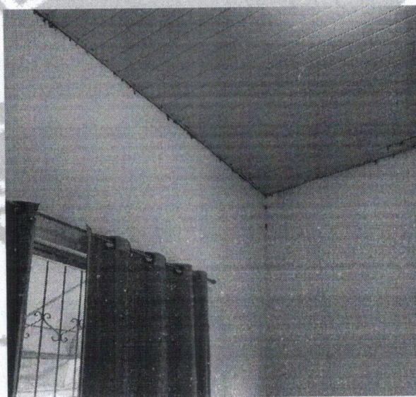
Figura 4 – Vista das consequências das infiltrações com presença de lodo.
