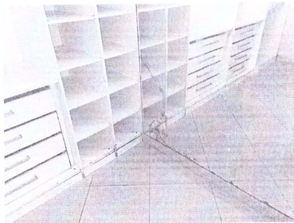
Figura 47: Vidro quebrado no closet da suíte principal
