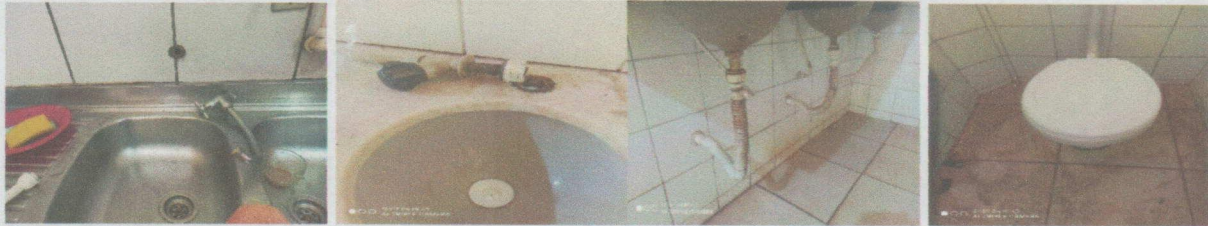
Parte Hidráulica danificados- Escola Antônio da Silva Pedroso
