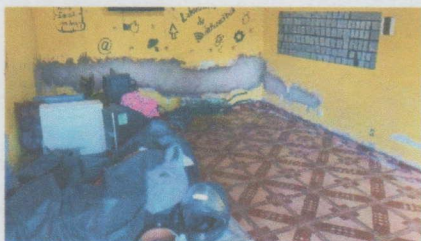
Escola São Sebastião- Parede apresenta desegregamento
