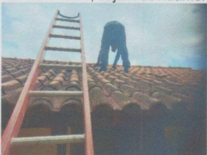
Telhado da Escola João Bianor apresenta muitas telhas danificadas
