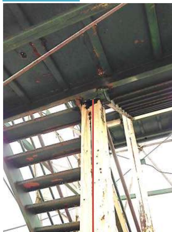
Corrosão na estrutura de apoio a escada.
