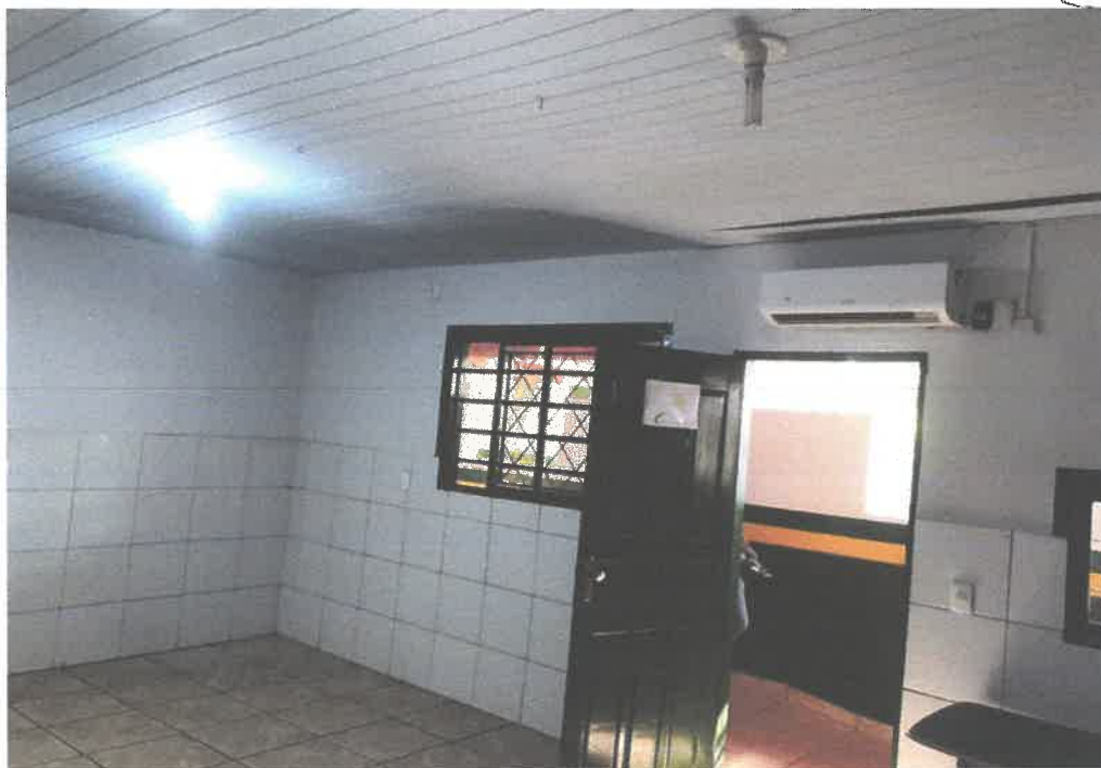
SALA ADMINISTRATIVA 02 (FORRO COM ALGUNS DEFEITOS) – INTERIOR
