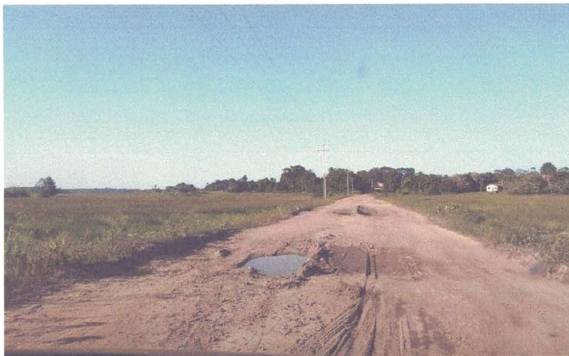
FOTO 11: Estrada na comunidade da Chapada. Trecho danificado.
