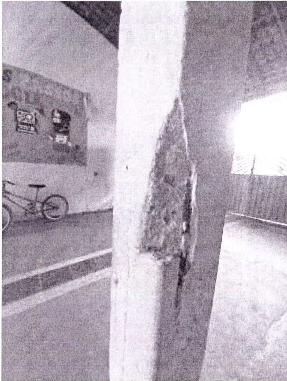
Figura 27 – Pilar com ferragem exposta
