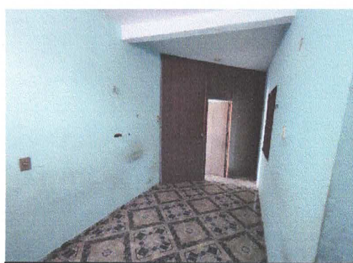
Imagem 10: Sala vedada com material de PVC. (Pavimento Superior)
