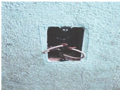
Imagem 13: Fiação Elétrica Exposta. (Pavimento térreo)
