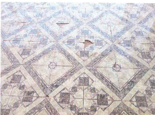
Imagem 17: Piso danificado no pátio do pavimento superior.
