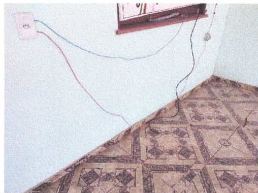
Imagem 14: Fiação Exposta no Pavimento Superior
