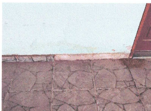
Imagem 16: Anomalia no rodapé do pátio no pavimento térreo.
