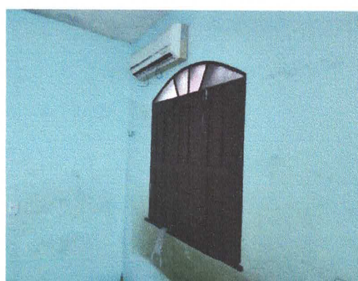
Imagem 12: AR condicionado da sala do Pavimento Superior
