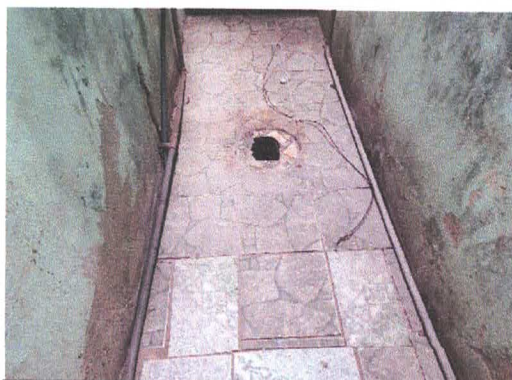
Imagem 18: Abertura no piso na área de serviço (pavimento térreo).
