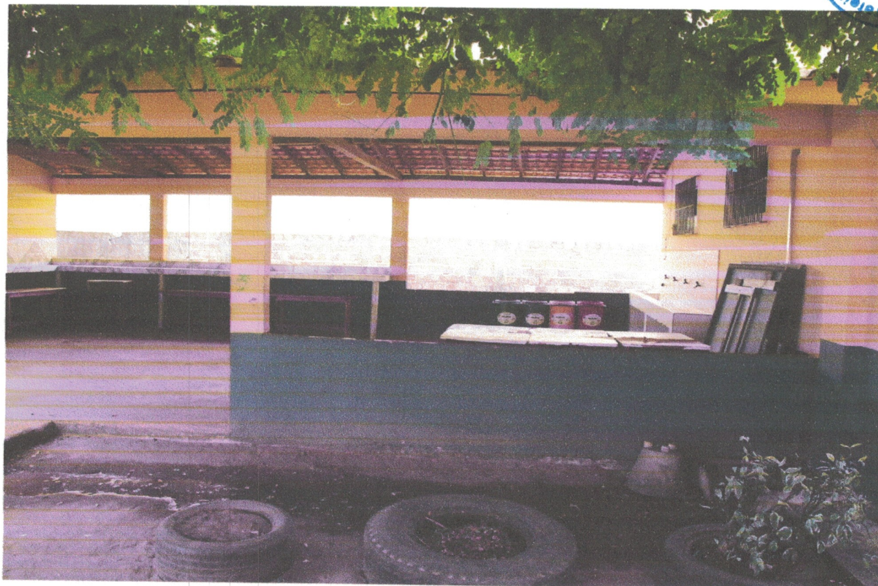
Figura 06: Área de recreação – falta revestimento de Piso
