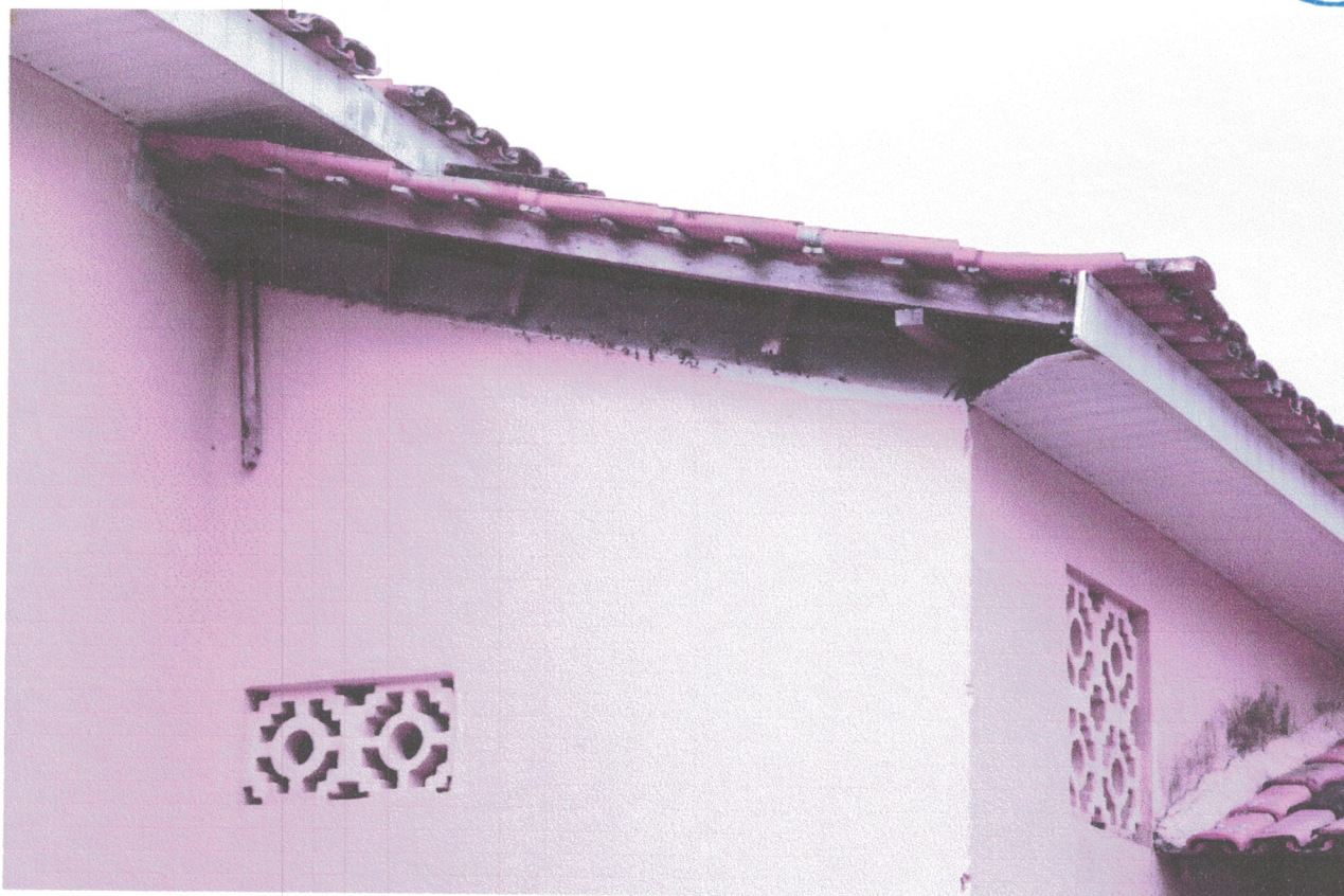
FIGURA 03: Telhado com forro danificado
