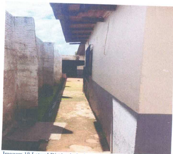
Imagem 18 Lateral Direita do Imóvel, pintura precisa de manutenção
