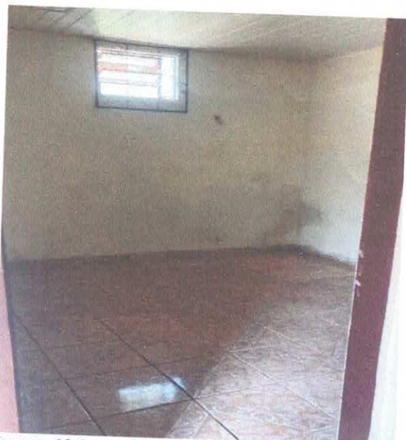
Imagem 12 Quarto 3, precisa ser corrigido umidade e pintura
