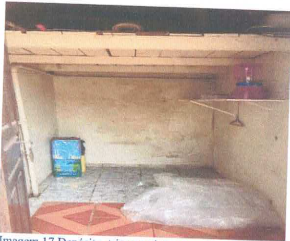
Imagem 17 Depósito, trinca e pintura precisa ser corrigida
