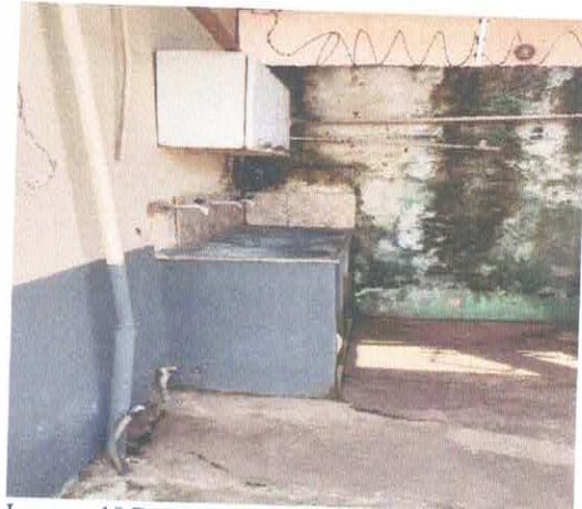
Imagem 18 Depósito, pintura precisa de manutenção
