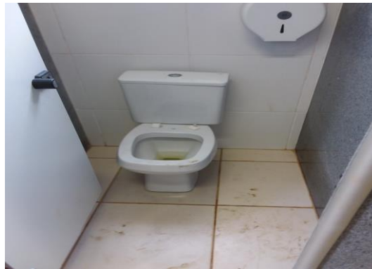
Problemas com vasos sanitários/Ausência de mictórios
