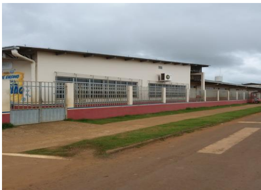
Cerca elétrica e concertina inexistente
