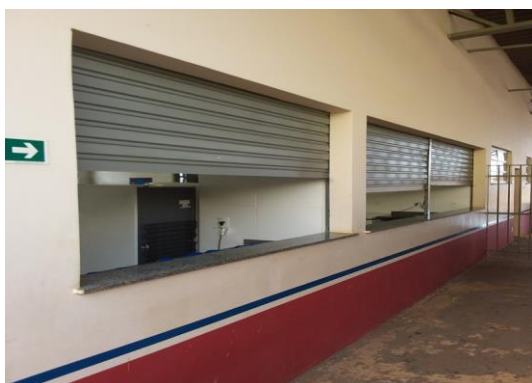
Tela de proteção na abertura externa ausente
