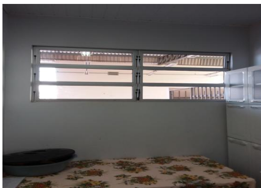
Tela de proteção na abertura externa ausente
