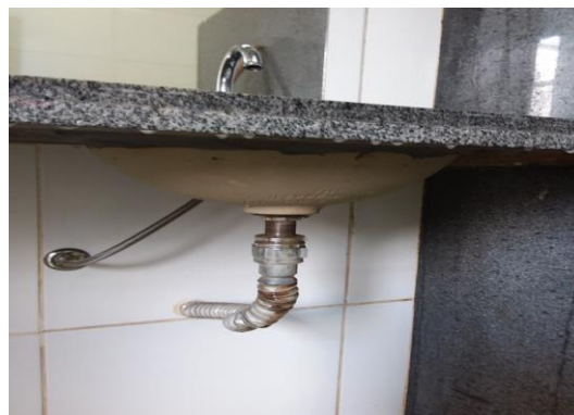
Problema com lavatório
