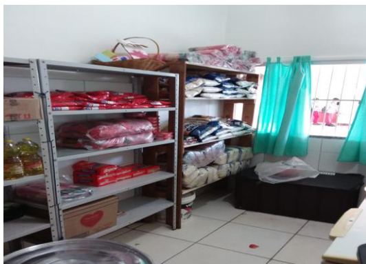
Tela de proteção na abertura externa ausente e espaço reduzido
