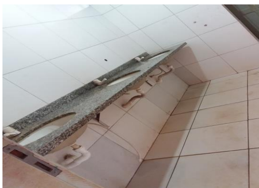
Problemas com torneiras/ lavatórios e vazamentos
