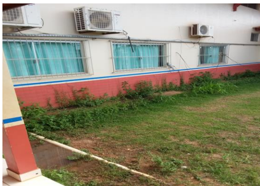
Necessidade de capinação
