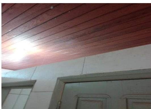
Cobertura com goteiras e infiltrações
