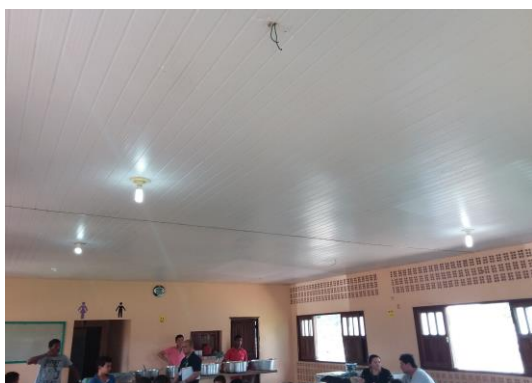
Lâmpadas ausentes e Instalações sanitárias e/ou vestiários em comunicação direta com o refeitório.
