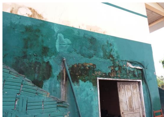
Pintura danificada e Infiltrações
