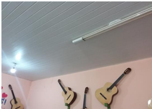
Lâmpadas queimadas / inexistentes
