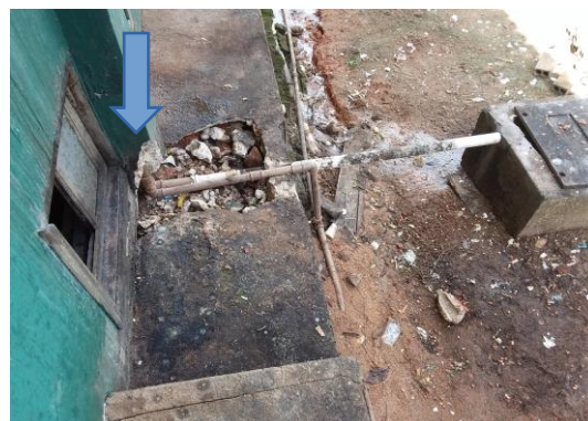
Queda de reboco e piso danificado
