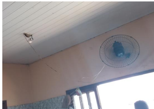
Lâmpada ausente, fiações improvisadas e existência de ventilador.
