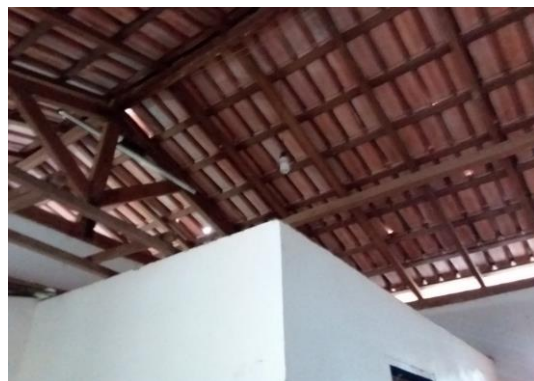
Lâmpadas queimadas e forro ausente
