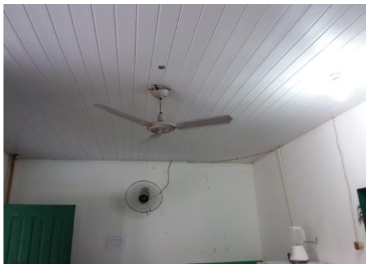
Forro danificado e existência de ventiladores
