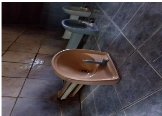
Problemas com torneiras/lavatório(s)
