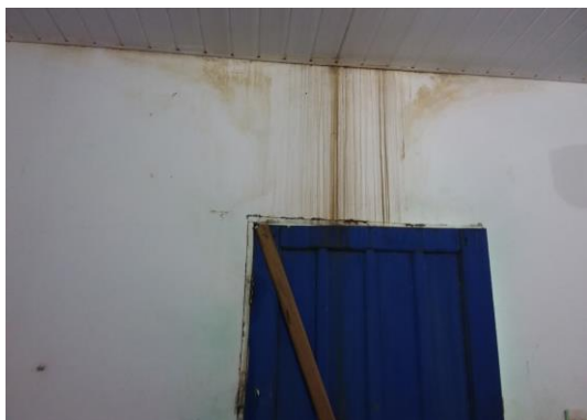
Pintura danificada e infiltrações
