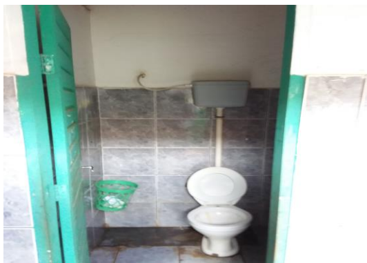
Problemas com vaso(s) sanitário(s)
