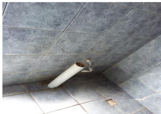
Problemas com mictório(s) e Equipamentos sanitários insuficientes
