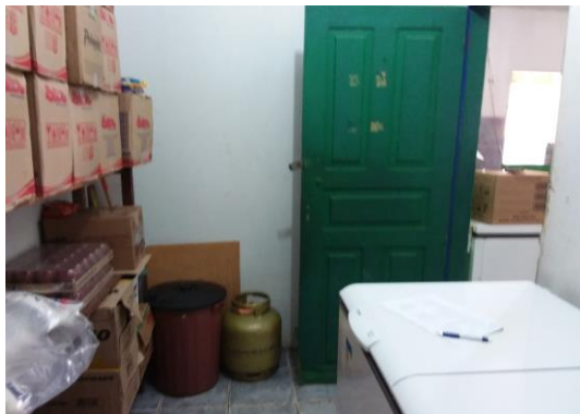
Portas danificadas e armazenamento de botijão de gás
