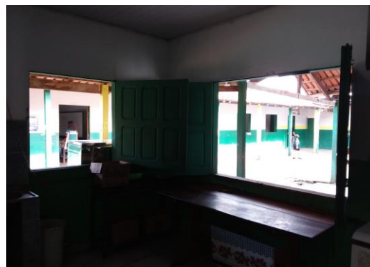
Tela de proteção na abertura externa ausente
