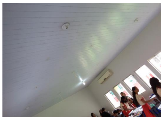
Forro danificado e Lâmpadas ausentes
