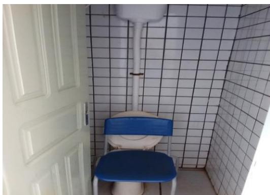
Problemas no vaso sanitário
