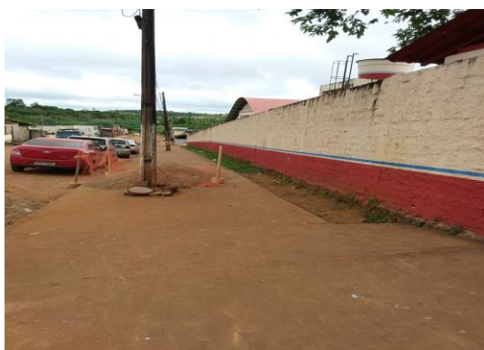
Cerca elétrica e concertina inexistente
