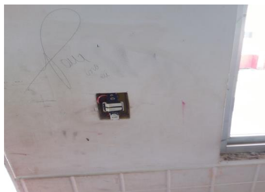
Pintura danificada e Fiações expostas
