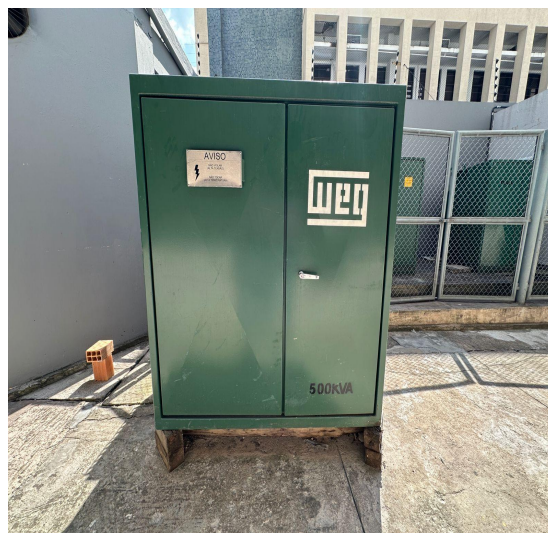
Imagem 2 - Transformador de 500kVA (Ativado)
