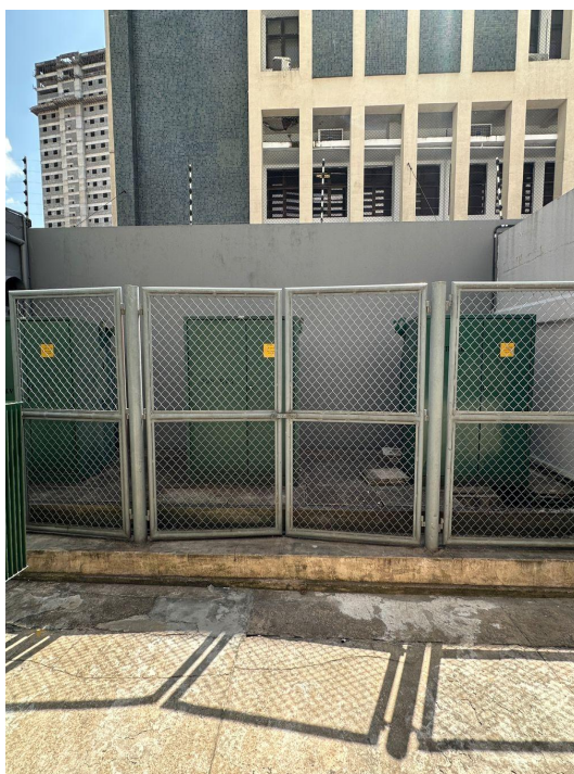
Imagem 4 - Disposição correta dos transformadores
