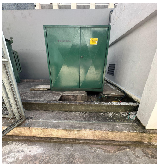
Imagem 1 - Transformador 300 kVA (Desativado)
