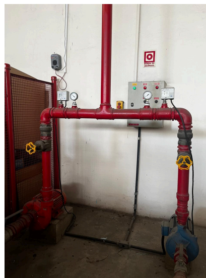
Fazer reparo no sistema de pressurização
