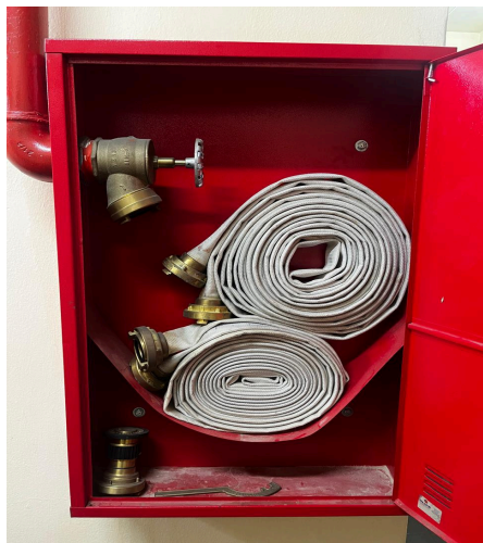
Hidrante 1 - Reparo como um todo e troca das Mangueiras para Tipo II de 15m cada, conforme NBR 11861 - Mangueiras de combate a incêndio.
