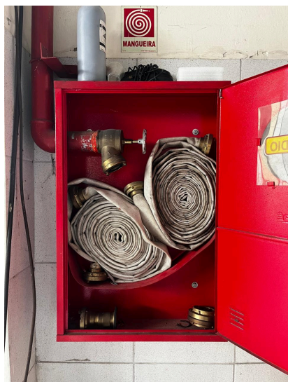
Hidrante 3 - Reparo como um todo e troca das Mangueiras para Tipo II de 15m cada, conforme NBR 11861 - Mangueiras de combate a incêndio.
