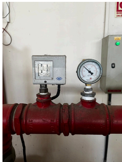
Fazer reparo no sistema de pressurização
