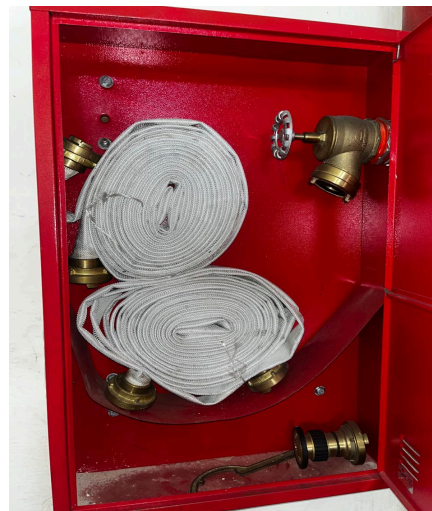
Hidrante 2 - Reparo como um todo e troca das Mangueiras para Tipo II de 15m cada, conforme NBR 11861 - Mangueiras de combate a incêndio.
